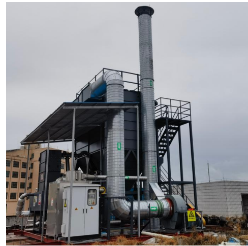
楼顶废气处理设施及废气排放口
