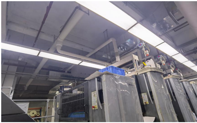
1楼印刷工位及印刷废气收集装置
