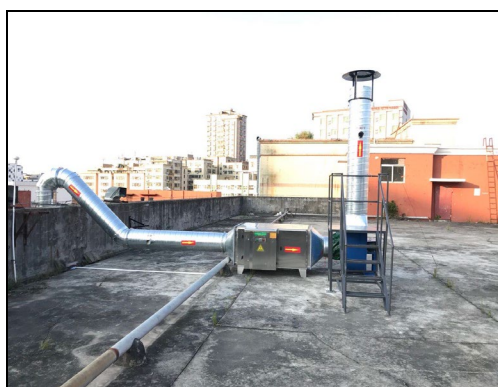
楼顶废气处理设施
