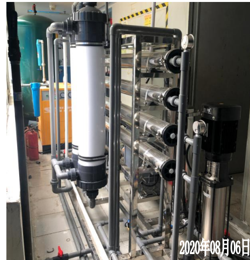
项目循环水处理系统
